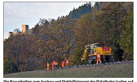
Die Bauarbeiten zum Ausbau und Elektrifizierung der Elztalbahn laufen auf Hochtouren. Dennoch verzögert sich die Inbetriebnahme wohl auf Juni 2021.
